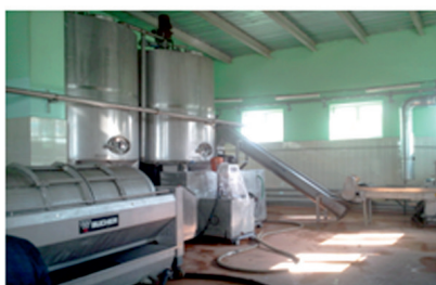
Оборудования участка обезвоживания картофельной мезги
